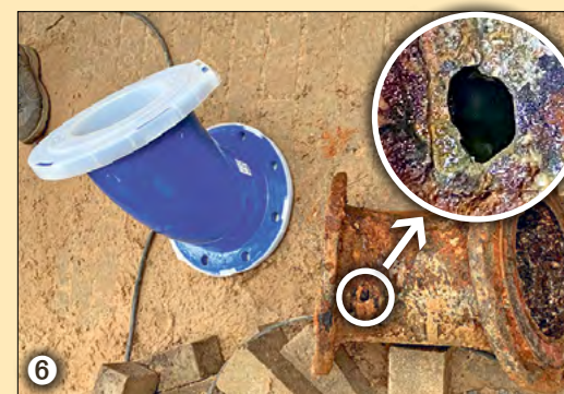
Kleines Loch – großes Problem. Der verrostete Leitungsbogen wird ausgetauscht.
