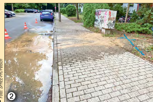
Blitzschnell ist ein Rohrnetzmitarbeiter vor Ort und ermittelt die Schadensstelle (blaues Kreuz).
