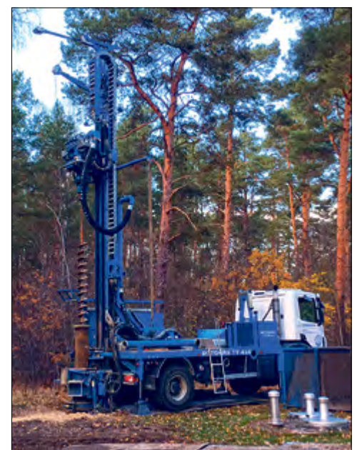
Auf dem Gelände des Wasserwerks Ludwigsfelde haben die Bohrungen begonnen. Foto: WARL
