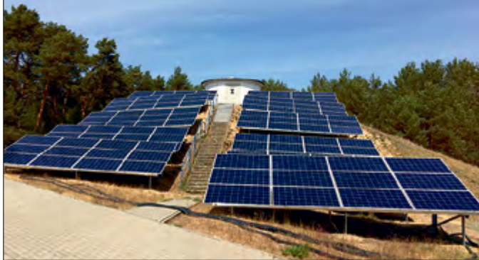
Auf dem Hang überm Reinwasserbehälter ist viel Platz für Solar-Module zur Stromerzeugung für den Eigenbedarf. Foto: Foto: KMS/Langleist
