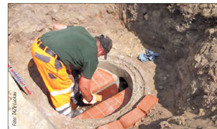
Zum umfassenden Kanalsanierungsprojekt des TAZV gehörte auch die Instandsetzung von insgesamt 182 Schächten im Stadtgebiet.
