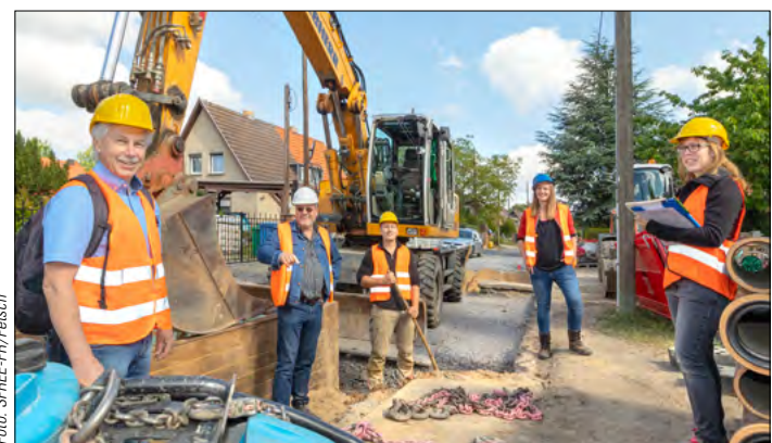
Die Fünf von der Baustelle Waldstraße: Dr.-Ing. Thomas Stammnitz (Ludwigsfelde), Bauleiter Olaf Fibian (Ingenieurbüro), LauBau-Polier Marcus Thamm, Kathrin Herbst (DNWAB) und Annica Meier vom Ingenieurbüro Drömer (v.l.).
