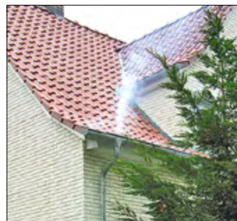
Steigt weißer Dunst aus der Regenrinne, ist das eindeutig: Hier wird Regenwasser in die Kanäle eingeleitet. Foto: SPREE-PR/Archiv
