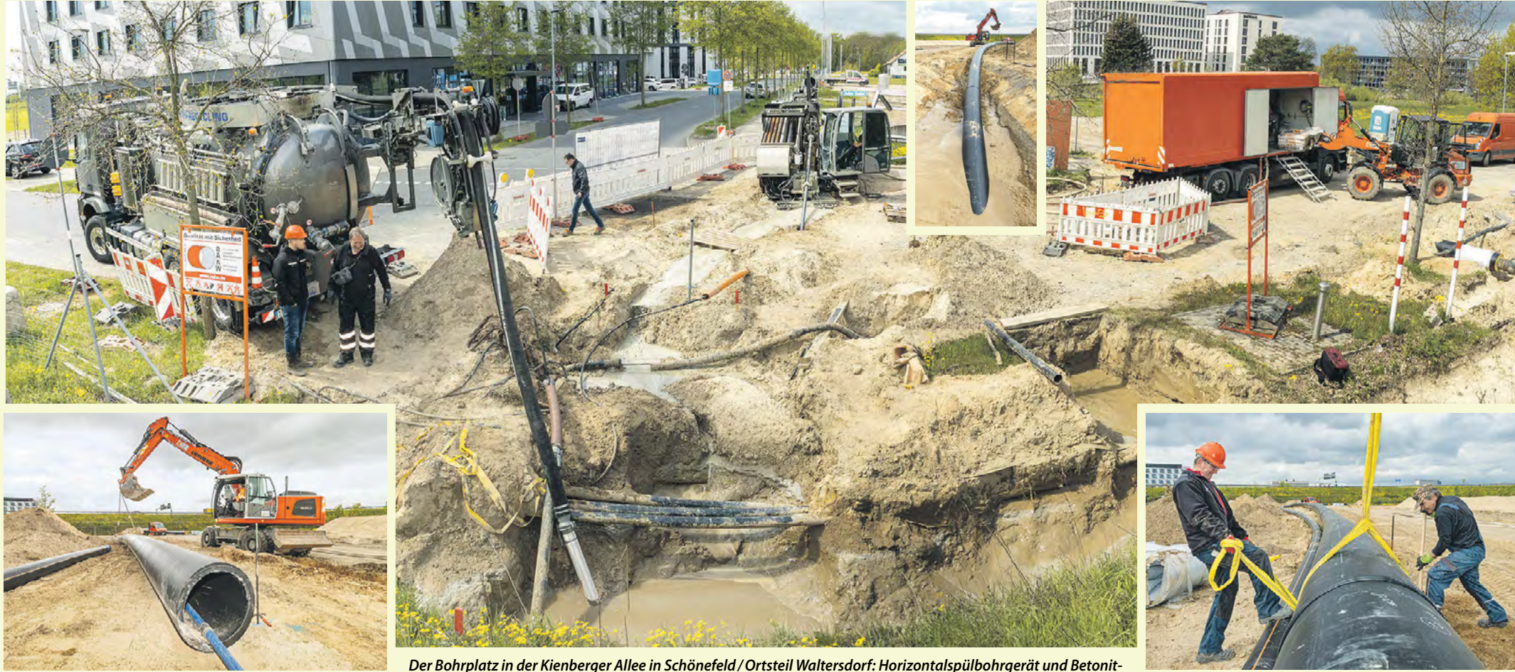
Ein 40 cm starkes Abwassermedienrohr wird mit „Ballastschlauch“ eingezogen und in die Erde gebracht (kleines Foto).
