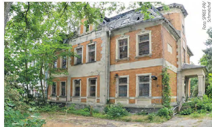
Seit mehr als zwei Jahrzehnten verfällt die alte Villa Picht in der Bahnhofstraße 6 in Königs Wusterhausen. Ab 2024 wird sie saniert.
